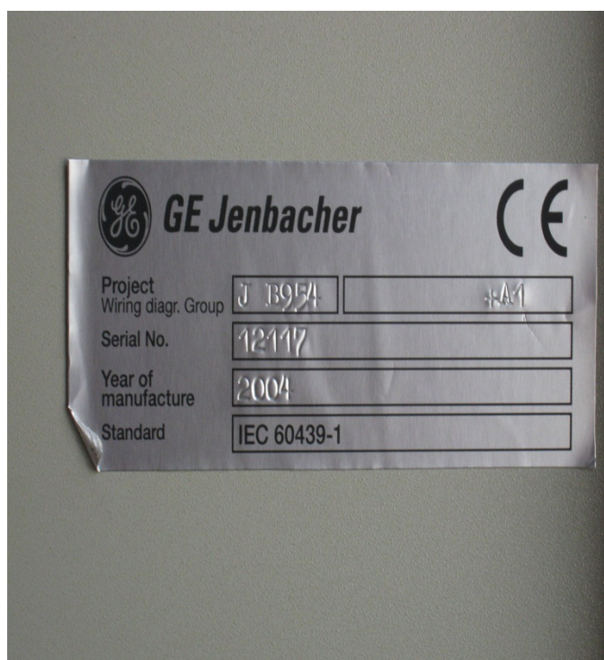
TARGHETTA DI RIFERIMENTO QUADRO ELETTRICO JENBACHER
